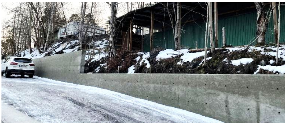
Fastigheten Lyftkranen 2 med slänt som möts av ett L-stöd av betong på intilliggande fastighet Lyftkranen 3 (Bonver Logistics).
