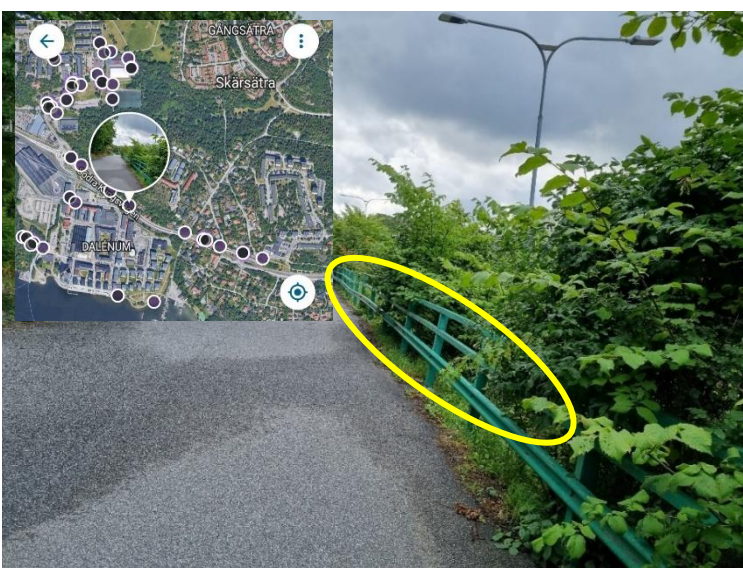
Figur 24. Räckets mellan GC-vägen och S:a Kungsvägen har drabbats av sättningsskador alt. rörelser i släntkrön.
