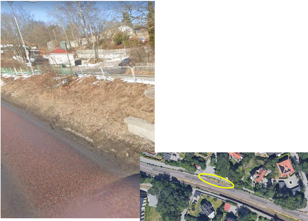
Figur 23. I delar av S:a Kungsvägen saknas stödmuren helt och släntfoten hamnar inom vägområdet. Räckets på släntkrönet har satt sig (Källa: Google maps).
