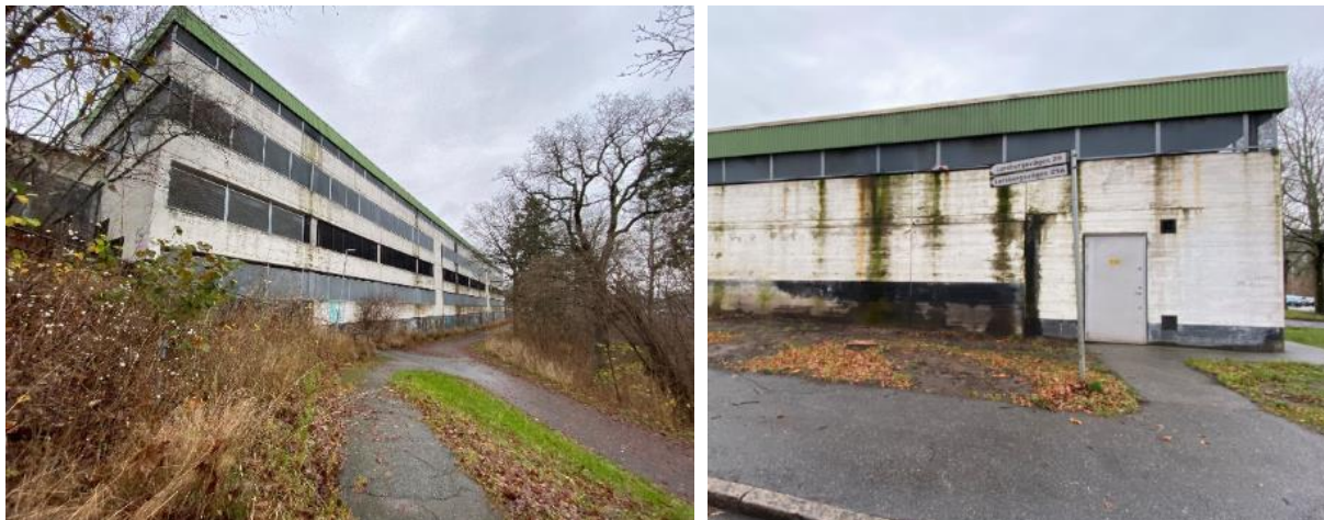
Figur 12. Observationer från platsbesök, 2020-11-25. Vattens tycks ha runnit utanpå fasad.
